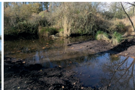
Création d'échancrures dans la berge pour restaurer la fonctionnalité hydraulique de la zone humide
